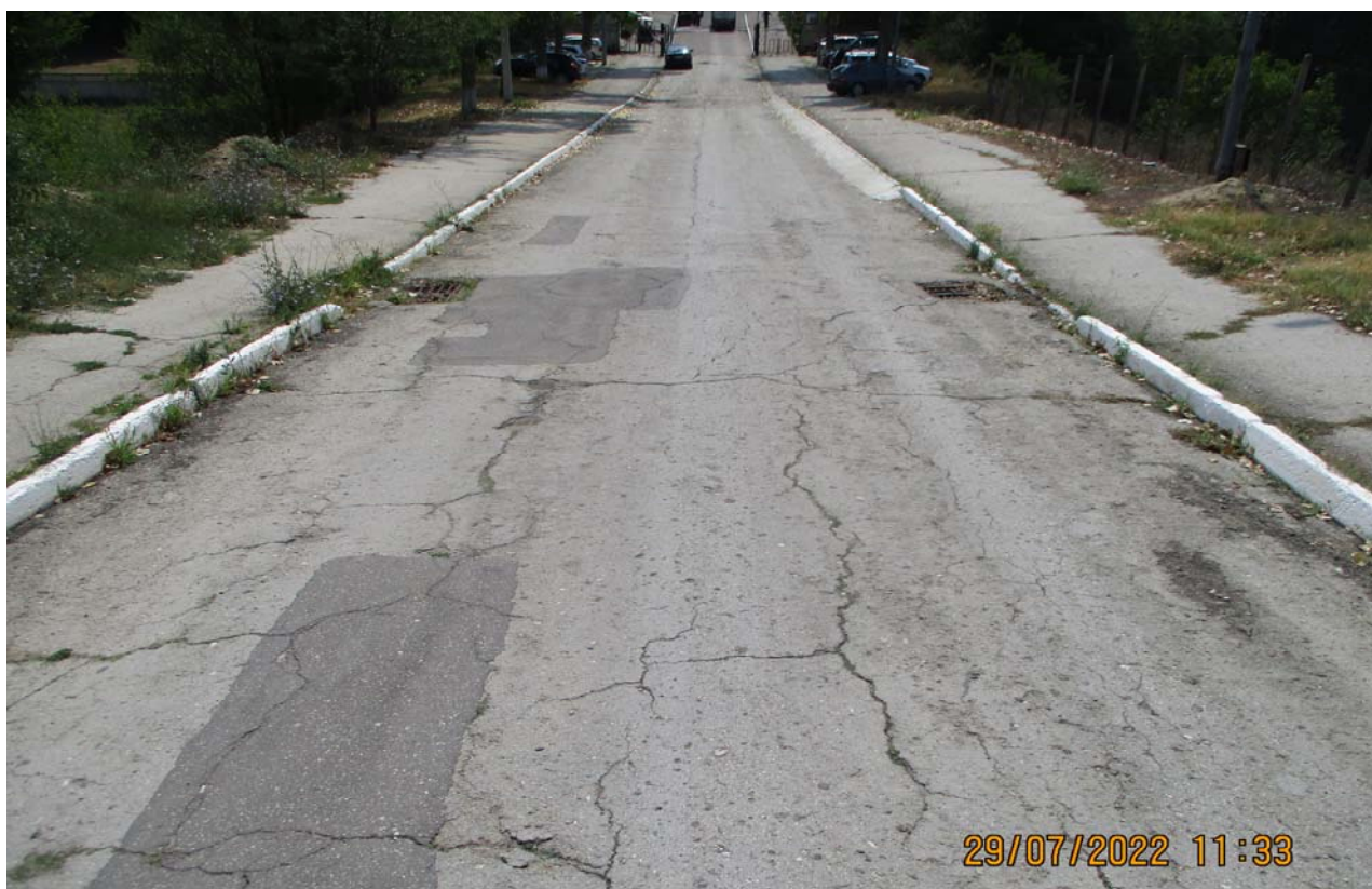
Figura 8. PC 11+00 ( sens direct ) – Drumul are calea de rulare executată din beton asfaltic. Sunt prezente crăpături transversale și faianțări în bloc, pelade și plombe. Trotuarele din sunt grav deteriorate. Lățimea părții carosabile – 6.5 m.
