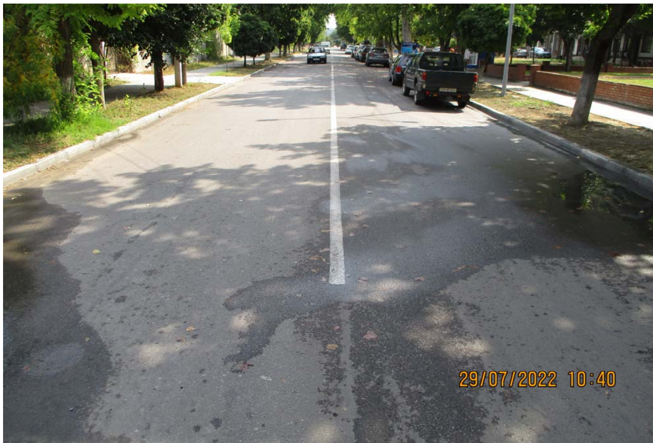
Figura 5. PC 6+50 ( sens direct ) – Drumul are calea de rulare executată din beton asfaltic recent reabilitată. Sunt prezente crăpături transversale pe alocuri. Lățimea părții carosabile – 9.0 m.
