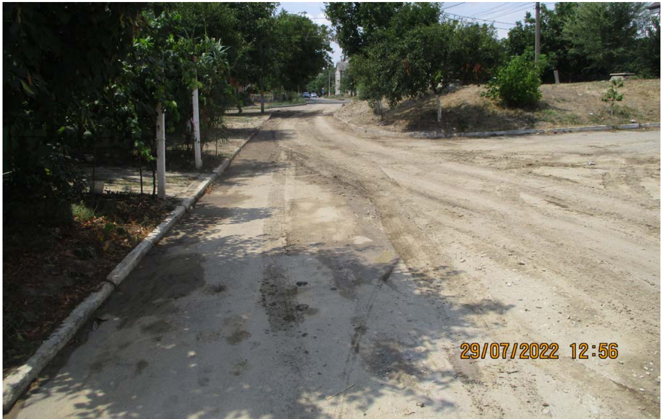
Figura 9. PC 10+60 ( str. B.P. Hașdeu ) – Drumul existent are calea din beton asfaltic cu imixtiuni de nămol, din cauza că apele pluviale nu sunt evacuate de pe suprafața căii de rulare, cu gropi și material rezultat de la rețeaua inginerescă recent pozată pe axa străzii. Lățimea părții caros. în zona activă, fără parcare – 3.5 m.
