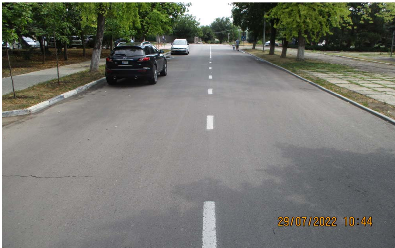
Figura 6. PC 8+00 ( sens direct ) – Drumul are calea de rulare executată din beton asfaltic recent reabilitată. Sunt prezente crăpături transversale pe alocuri. Trotuarele din apropierea Palatului de Cultură "Nicolae Botgros" sunt grav deteriorate. Lățimea părții carosabile – 9.0 m.
