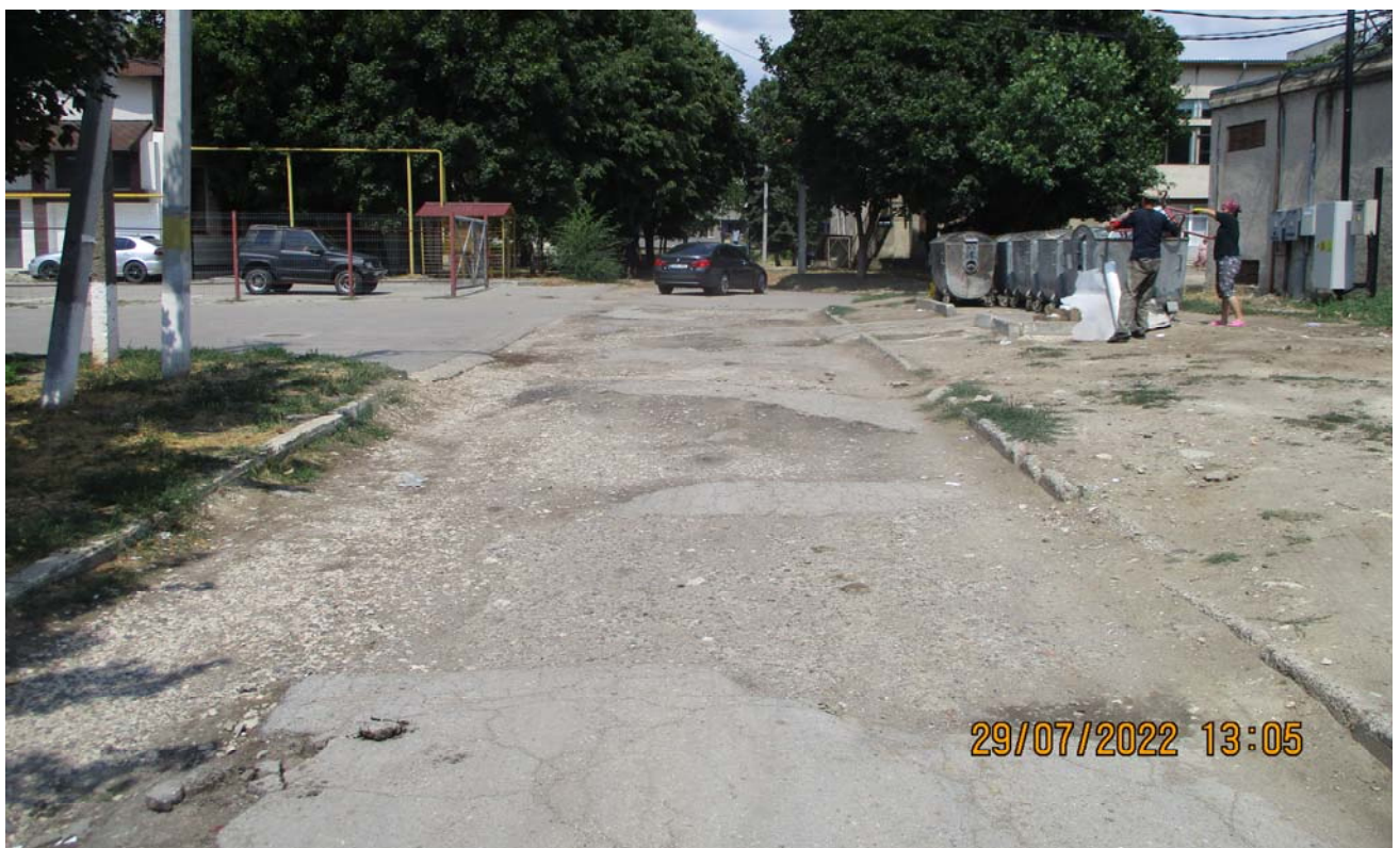
Figura 10. PC 00+60 ( str. Libertății ) – Drumul existent are calea din beton asfaltic cu imixtiuni de nămol, din cauza că apele pluviale nu sunt evacuate de pe suprafața căii de rulare, cu gropi și porțiuni de stradă cu dislocări masive de beton asfaltic. Lățimea părții carosabile – 5.2 m.
