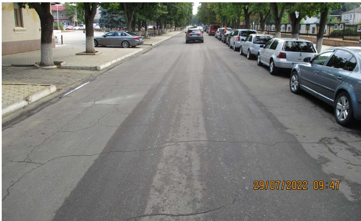
Figura 2. PC 2+00 ( sens direct ) – Drumul are calea de rulare executată din beton asfaltic. Sunt prezente crăpături transversale și longitudinale, pe alocuri faianțări în plăci. Lățimea părții carosabile – 9.5 m.
