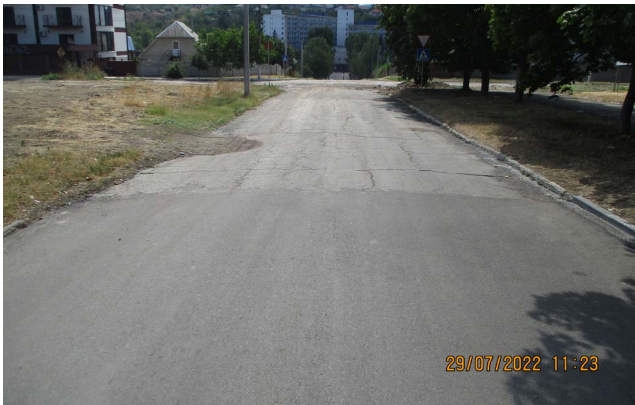
Figura 7. PC 9+50 ( sens direct ) – Drumul are calea de rulare executată din beton asfaltic. Sunt prezente crăpături transversale și faianțări în bloc. Trotuarele din apropierea Palatului de Cultură "Nicolae Botgros" sunt grav deteriorate. Lățimea părții carosabile – 7.6 m.
