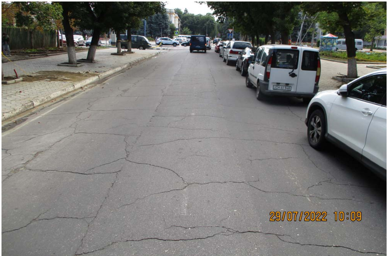
Figura 3. PC 3+50 ( sens direct ) – Drumul are calea de rulare executată din beton asfaltic. Sunt prezente crăpături transversale și longitudinale, pe alocuri faianțări în plăci. Lățimea părții carosabile – 9.0 m.
