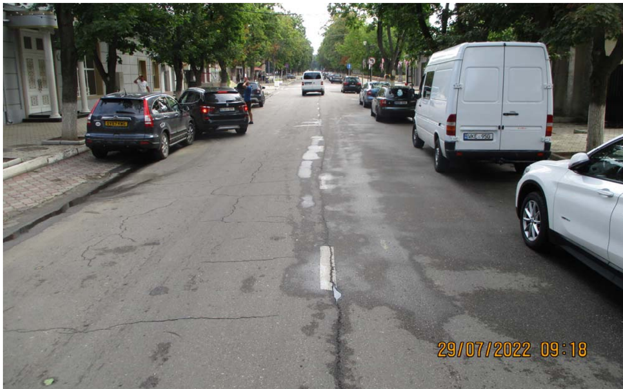
Figura 1. PC 0+20 ( sens direct ) – Drumul are calea de rulare executată din beton asfaltic. Sunt prezente crăpături transversale și longitudinale. Lățimea părții carosabile – 9.5 m.
