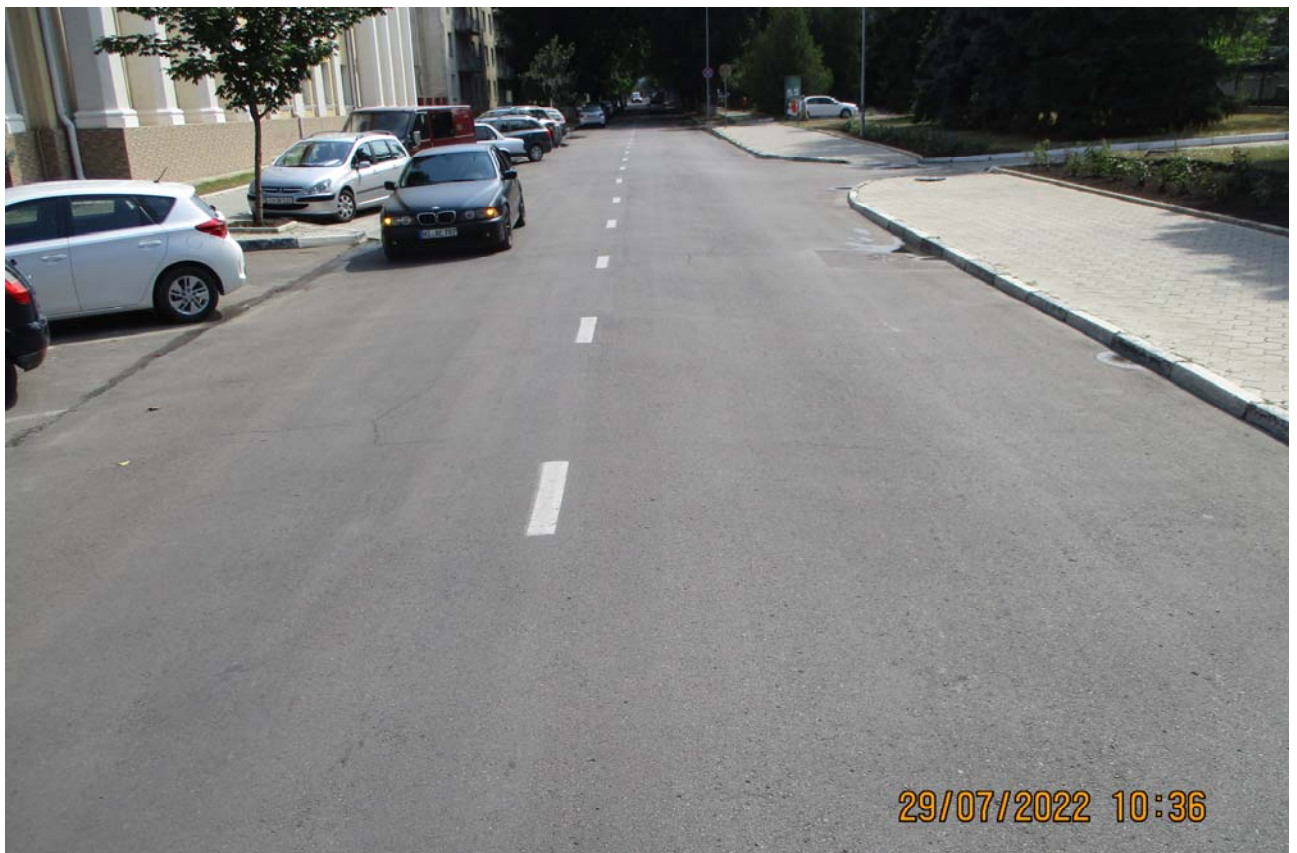
Figura 4. PC 5+00 ( sens direct ) – Drumul are calea de rulare executată din beton asfaltic recent reabilitată. Sunt prezente crăpături transversale pe alocuri. Lățimea părții carosabile – 8.5 m.
