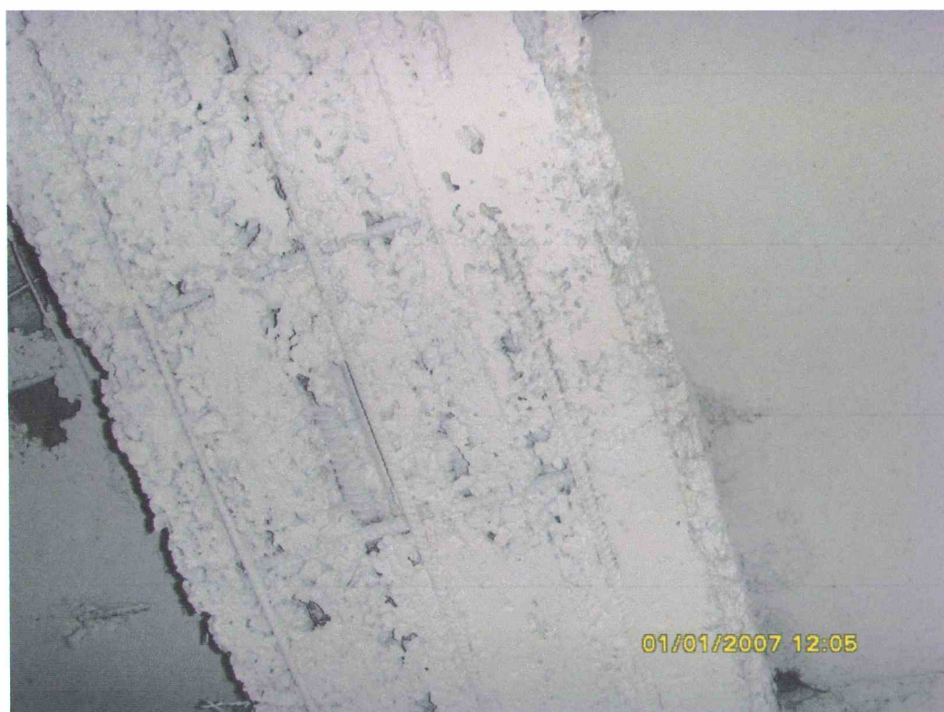
Anexa 8: Elemente structură planșeu peste subsol cu stratul de protecție al armăturii lipsă - Blocul lit.M .
