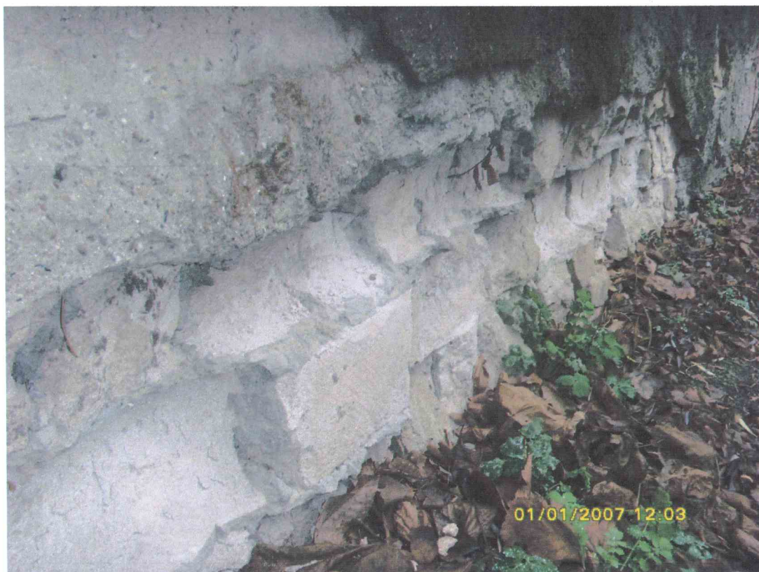
Anexa 7: Sector perete cu zidărie segregată - - Blocul lit.M.
