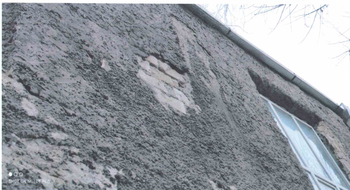
Anexa 22: Sector perete cu finisare distrusă și zidărie segregată - Blocul lit.J .
